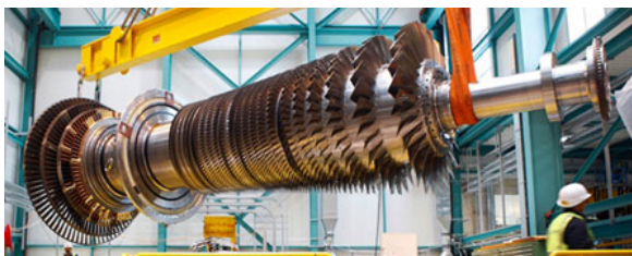
Turbine d'une centrale à gaz.
